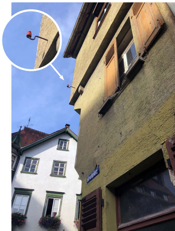
Abb. 16: Isolator für den Anschluss der Weckerlinie am Haus Bader beim Kirchplatz.
