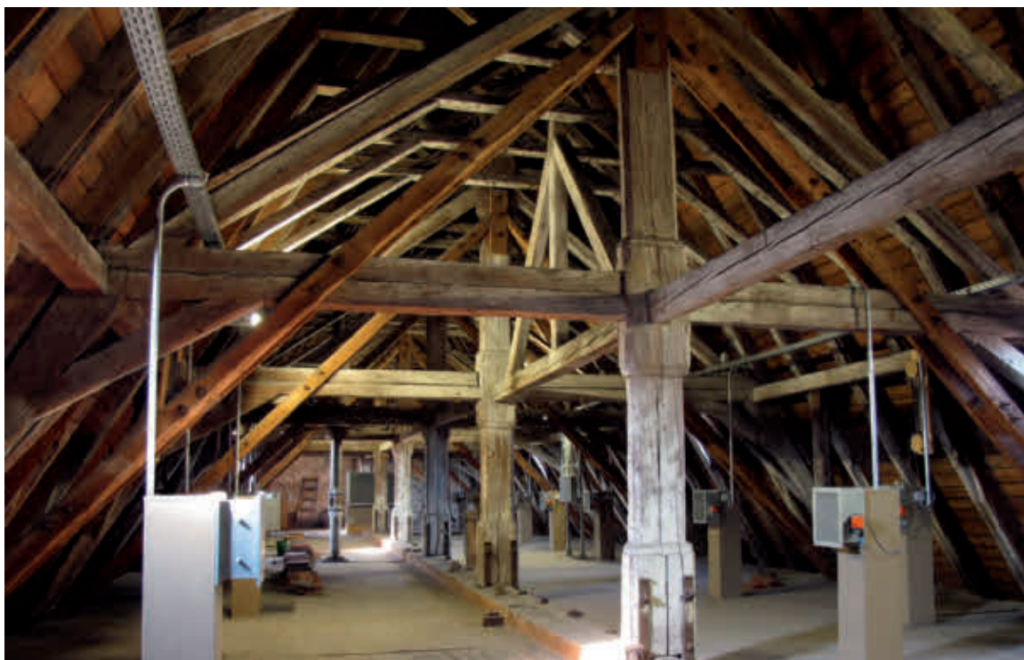
Dachstuhl der Stadtpfarrkirche St. Martin in Biberach mit moderner Belüftungsanlage. (Foto: Bodo Rüdenburg)
